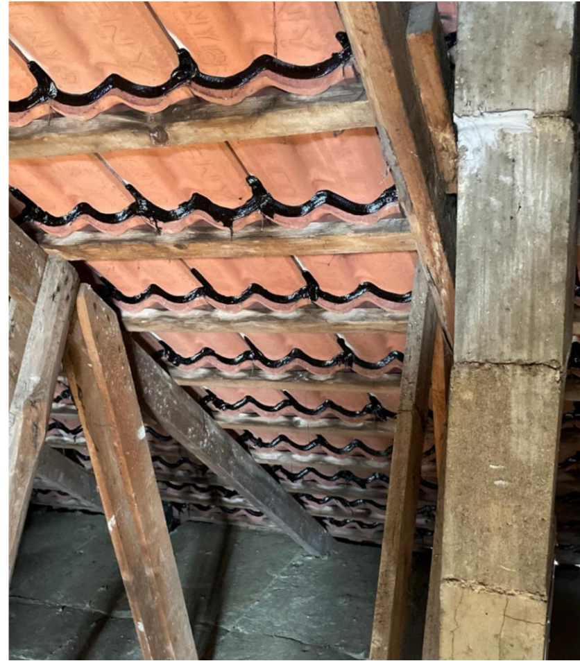
Betontagsten med bitumen understrygning blok 14 og 16.
